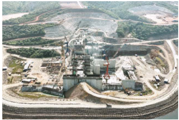
● 本行约翰内斯堡分行对几内亚阿玛利亚水电站进行贷前调查，高质量服务中资企业“走进非洲”。
