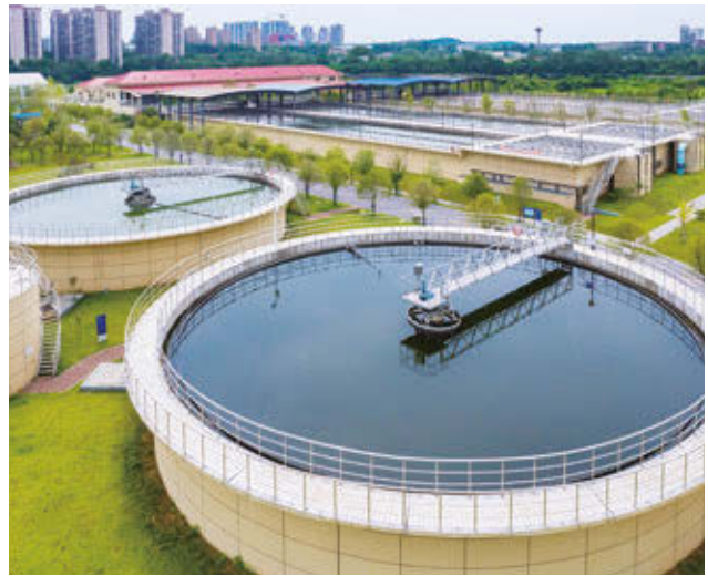
● 本行湖南省分行与长沙水业集团合作20余年，为其累计发放近15亿元贷款支持水源建设、污水处理等民生工程。图为长沙水业集团水源建设及污水处理设备运行场景。
